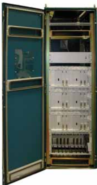
Infrastructure de signalisation
